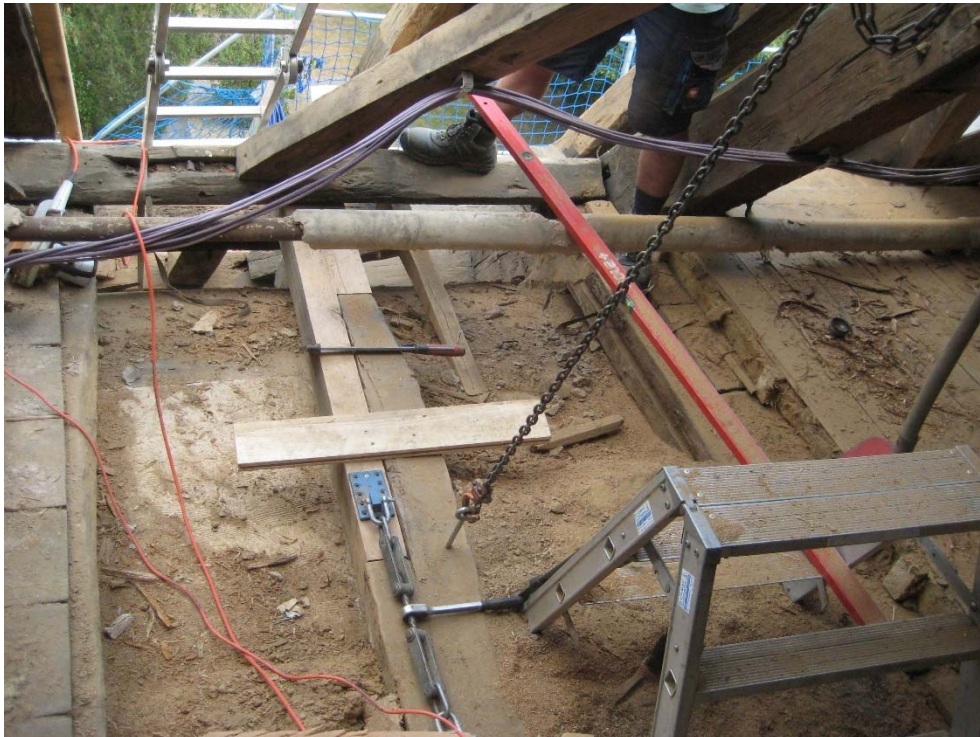
Ausgebauter, bis zur gesunden Substanz zurückgeschnittener Deckenbalken; angeschuhter Deckenbalken mit stehender Blattverbindung während der Montage.
